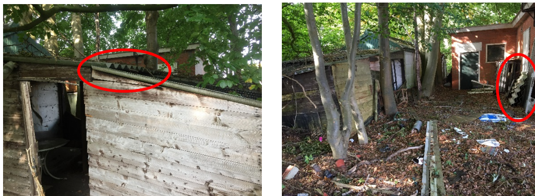
Figuur 4.1: Achterzijde huisnummer 63 en 65 met asbesthoudende golfplaten
