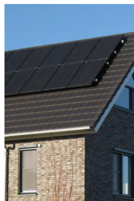
zonnepanelen op het dak
